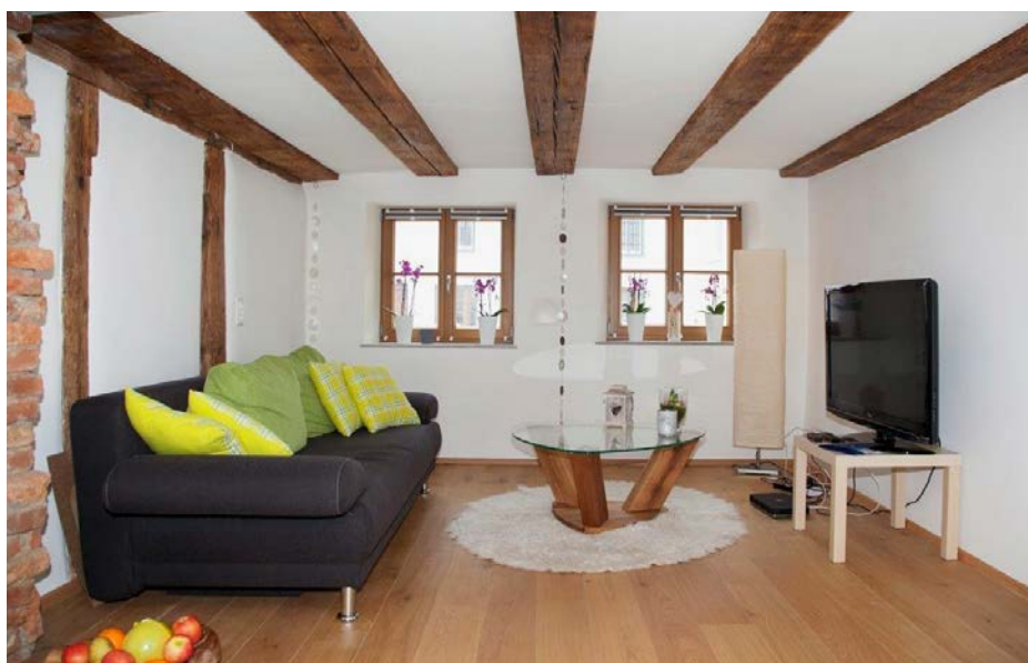
Die Deckenheizung wurde zwischen den Deckenbalken integriert und ist nicht zu erkennen.
