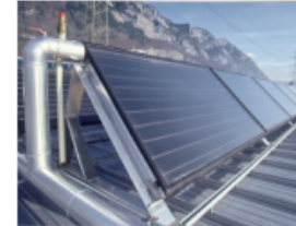
[Bild 5: Thermische Solaranlage]
